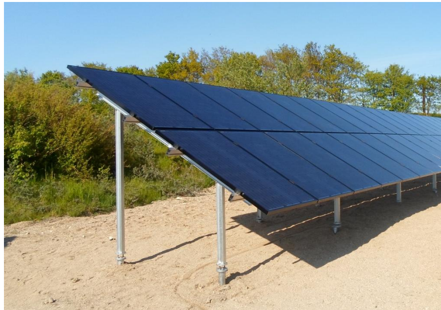
Anlæg med vores stativer til 2 rækker i 30 grader og på jordskruer ved Grenaa Varmeværk.
